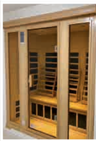
導入したサウナ設備
